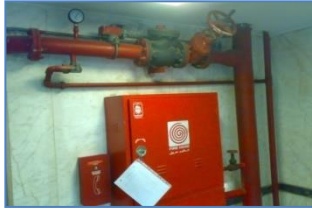
صندوق خراطيم مكافحة الحريق
